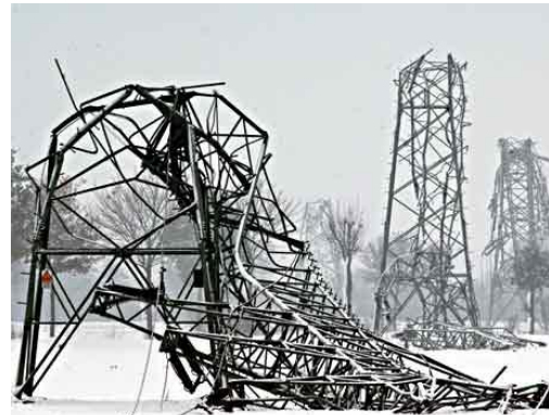
Münsterland November 2005 Durch Schnee- und Eislast auf den Leitungen zusammengebrochene Strommasten
