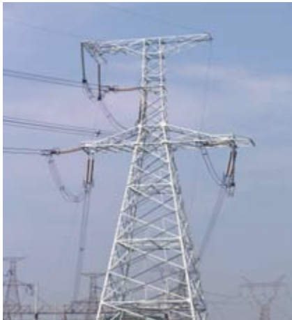
Freileitungsmast zur Stromversorgung (Quelle: VDI TZ)
